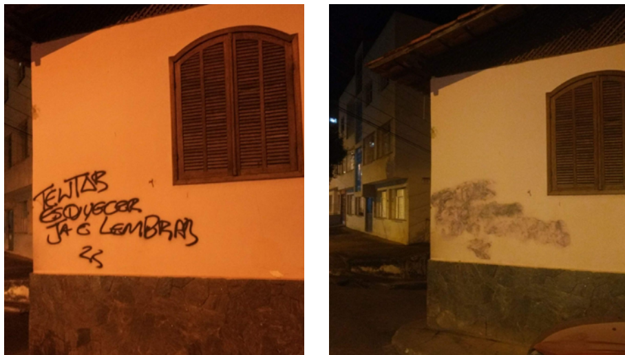
Figura 2: Muro de residência em jun/20 e em ago/20.
